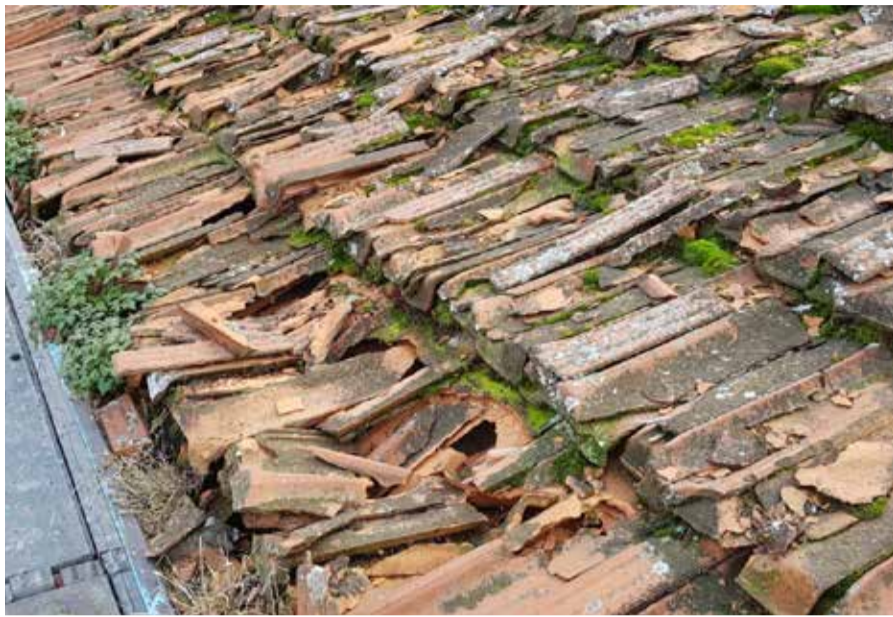
Tetto dell'immobile di via Milano distrutto dalla tempesta di settembre
