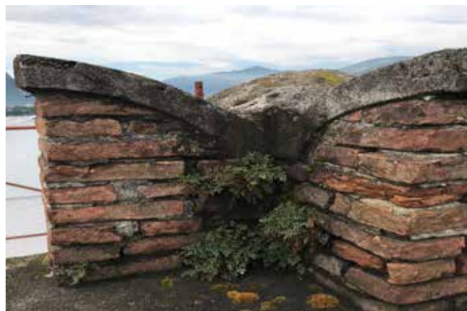
Merlo sommitale prima del restauro...
