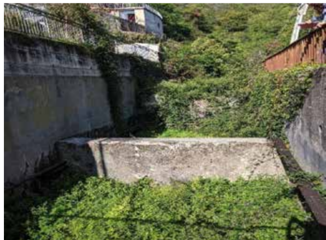
Stato precario delle vasche di laminazione
