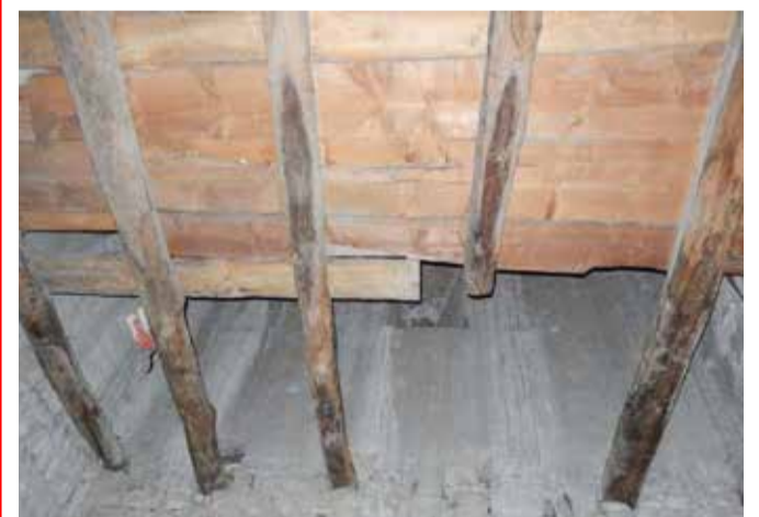
Condizioni precarie di stabilità di un pianerottolo di risalita del campanile
