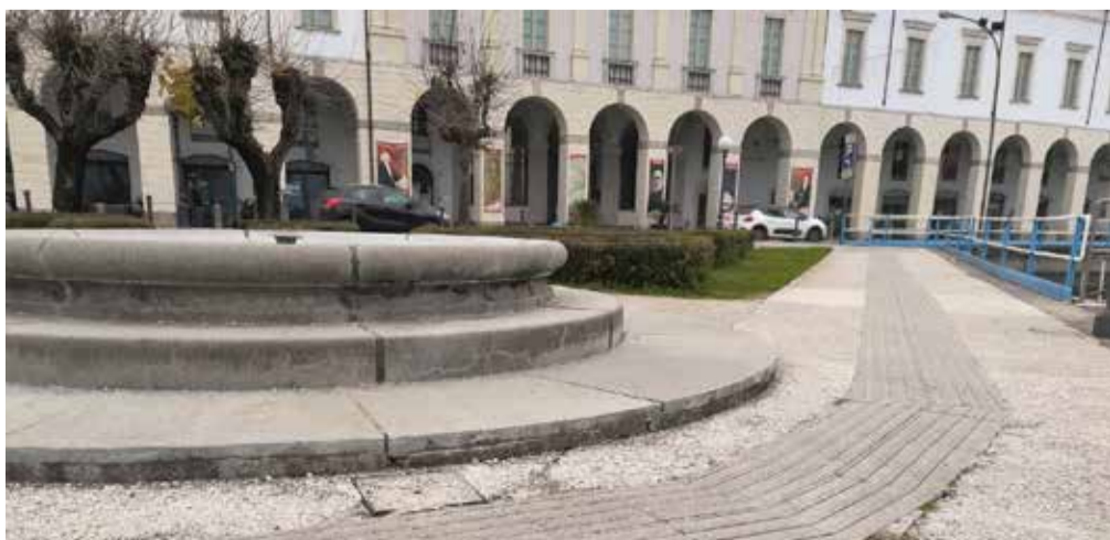
Instabilità del muro spondale che si trasmette anche alla fontana
